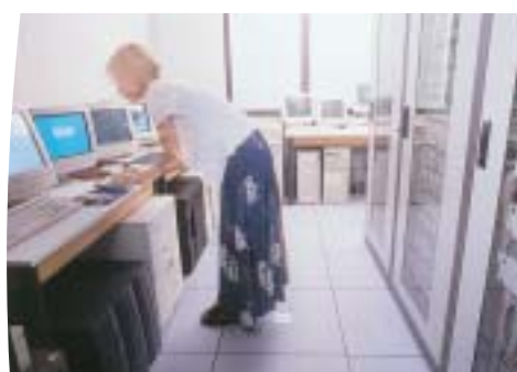
Tweevoudige stroomvoorziening voor apparatuur met enkelvoudige aansluiting.
